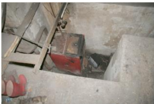
Kotelna - kotel ÚT
