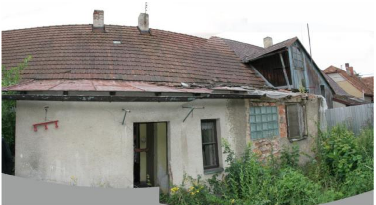
Panoramatický pohled ze dvorka (přístavba má zčásti zřícenou střechu)
